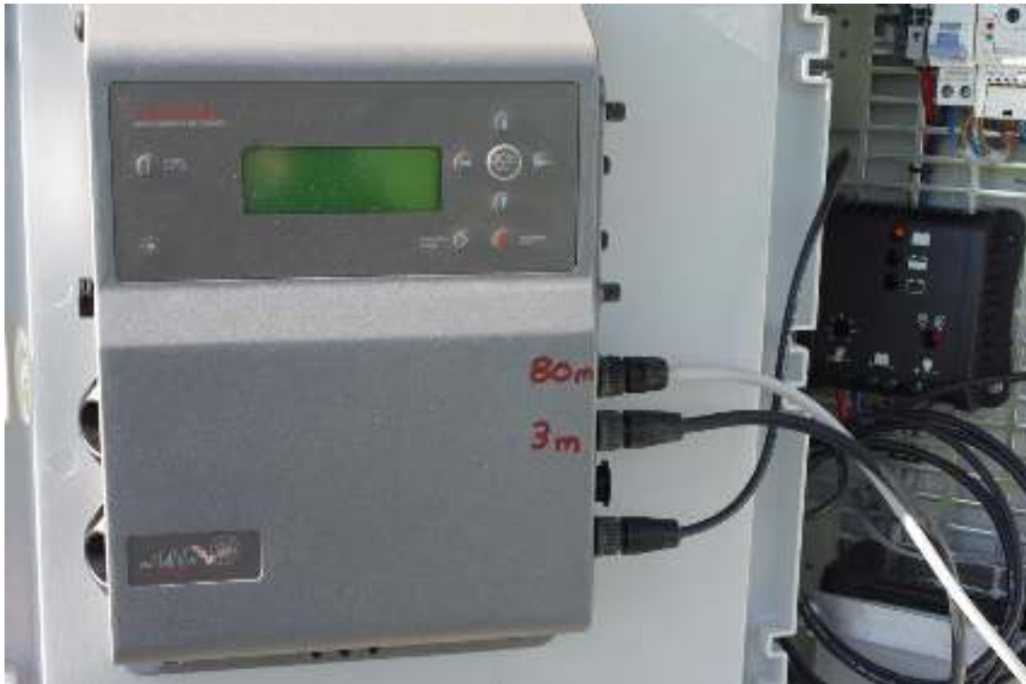
Figure 295 : SM3bat installé sur le mât de mesure avec ses deux sorties micros (source : Les Snats, 2018)
