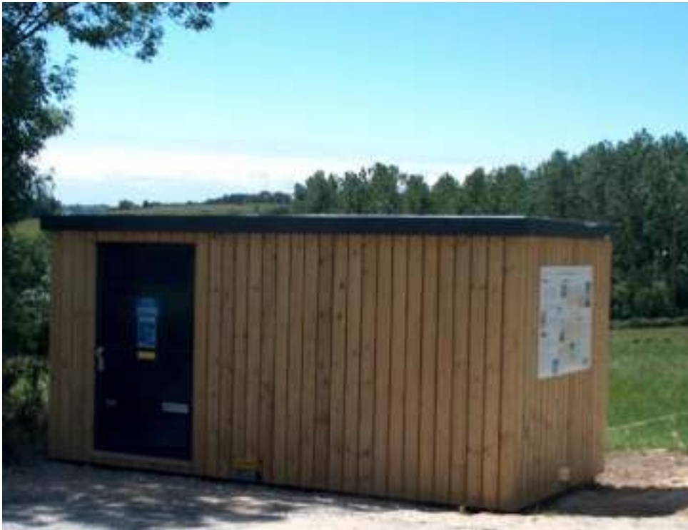
Figure 256 : Poste de livraison , bardage bois, SEL Enerbéton (source : VALECO, 2017)
